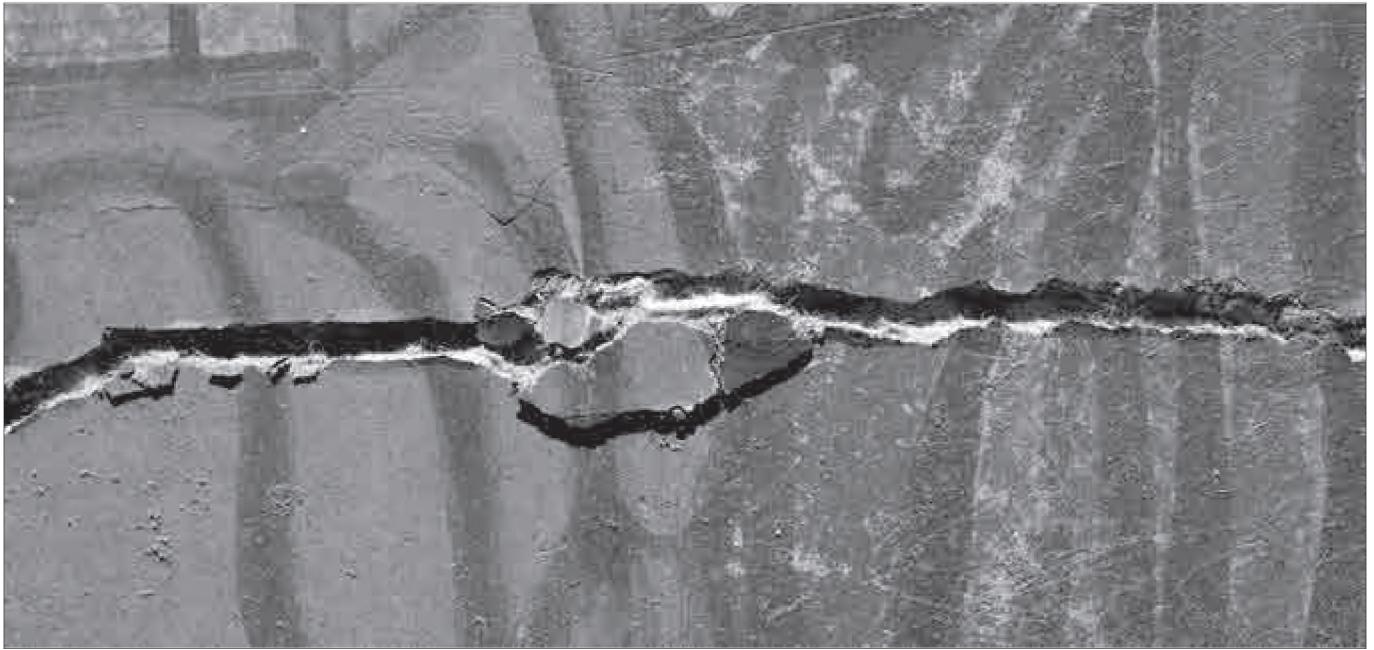
Рис. 3. Отслоение красочного слоя, грунта и частиц основы
